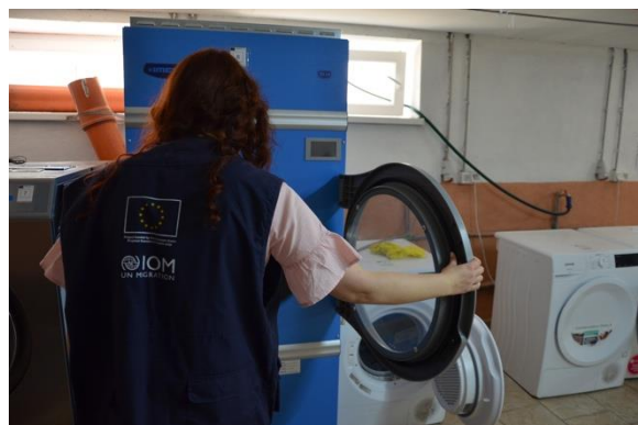
Laundry facility in TRC Blazuj, IOM
